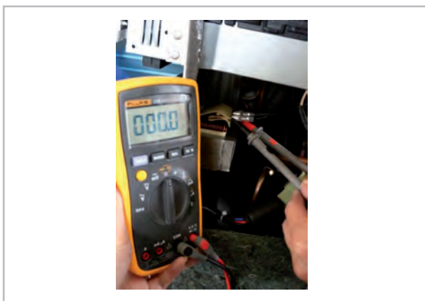
Abb. 46: Messung des Transformators
